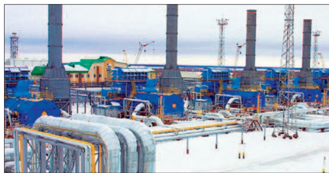
Gasdrukstation van Gazprom
